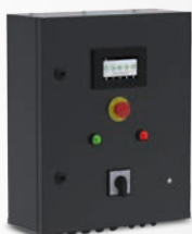
Szafa przemysłowa P3
